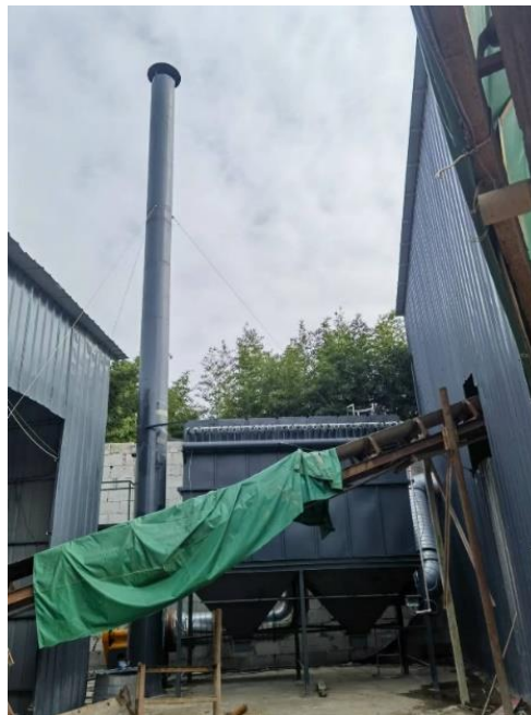
图 3.1-4 废气处理设施及排气筒
