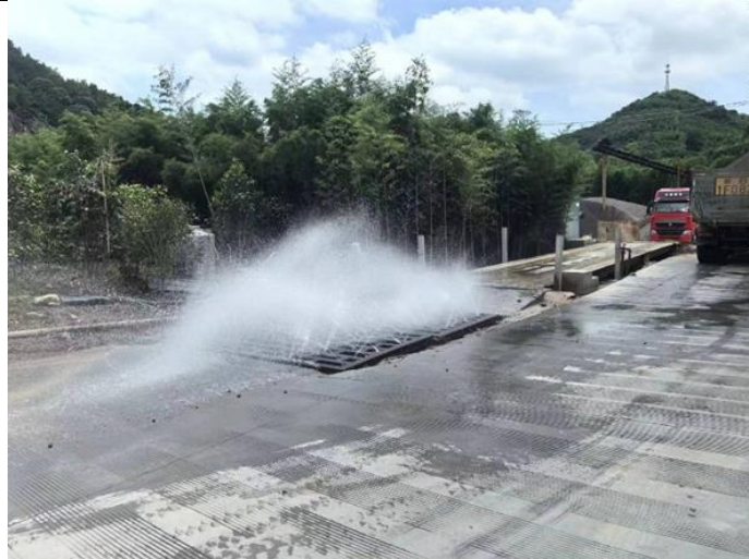
图 3.1-11 厂区西门车辆进出冲洗装置
