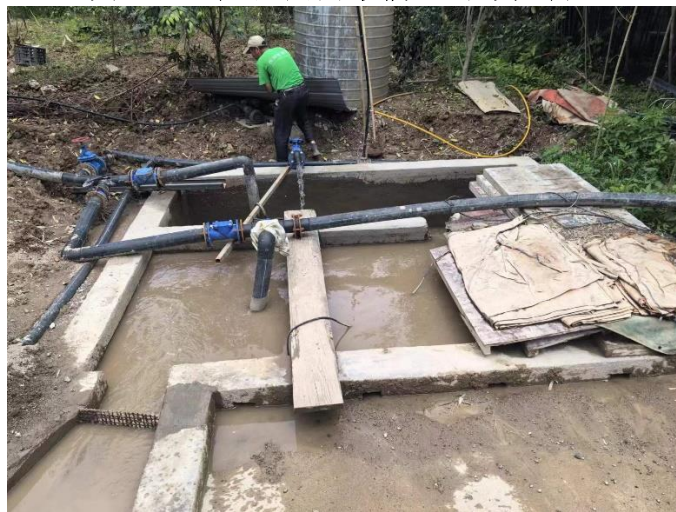
图 3.2-12 厂区西门车辆冲洗废水沉淀池
